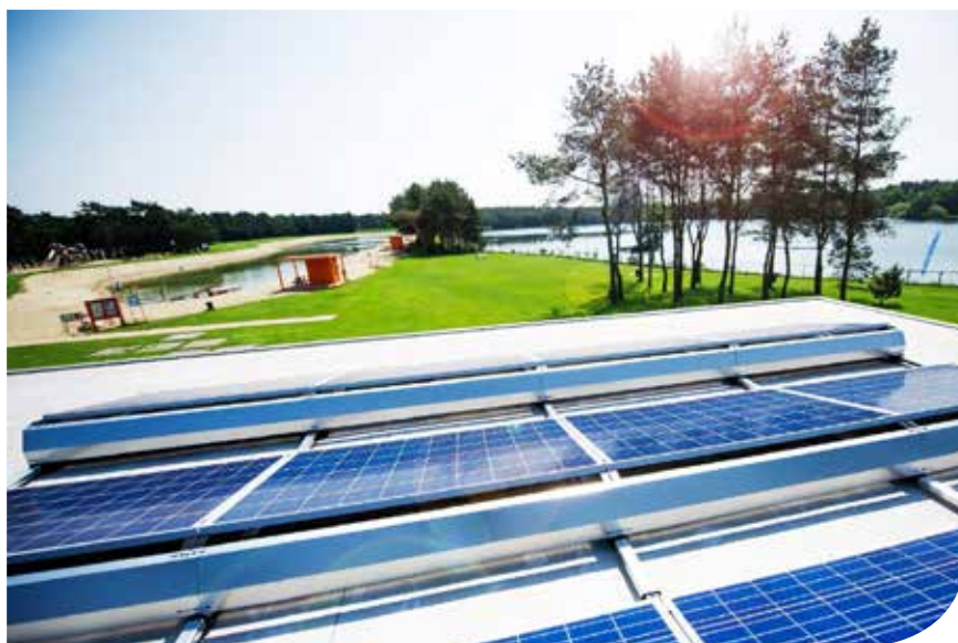
Op het dak van de brasserie van De Mosten zorgen zonnepanelen voor de nodige energie.
